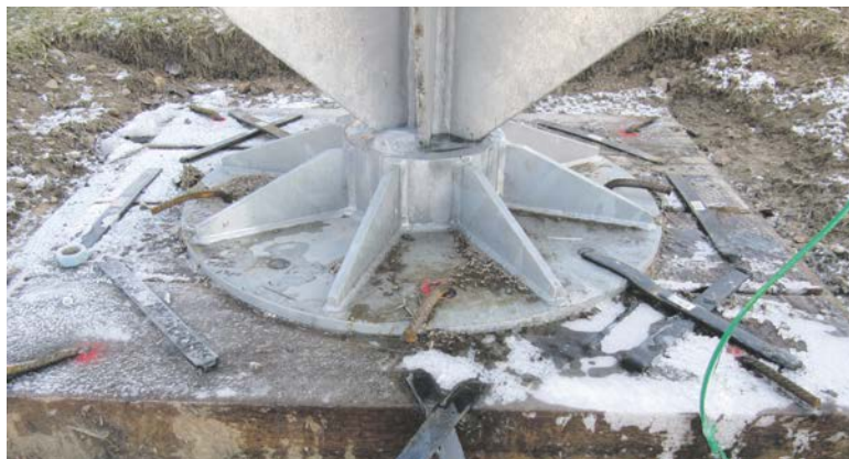
Nur wenig grösser als eine Hand: Die Auflagefläche des Masts.
