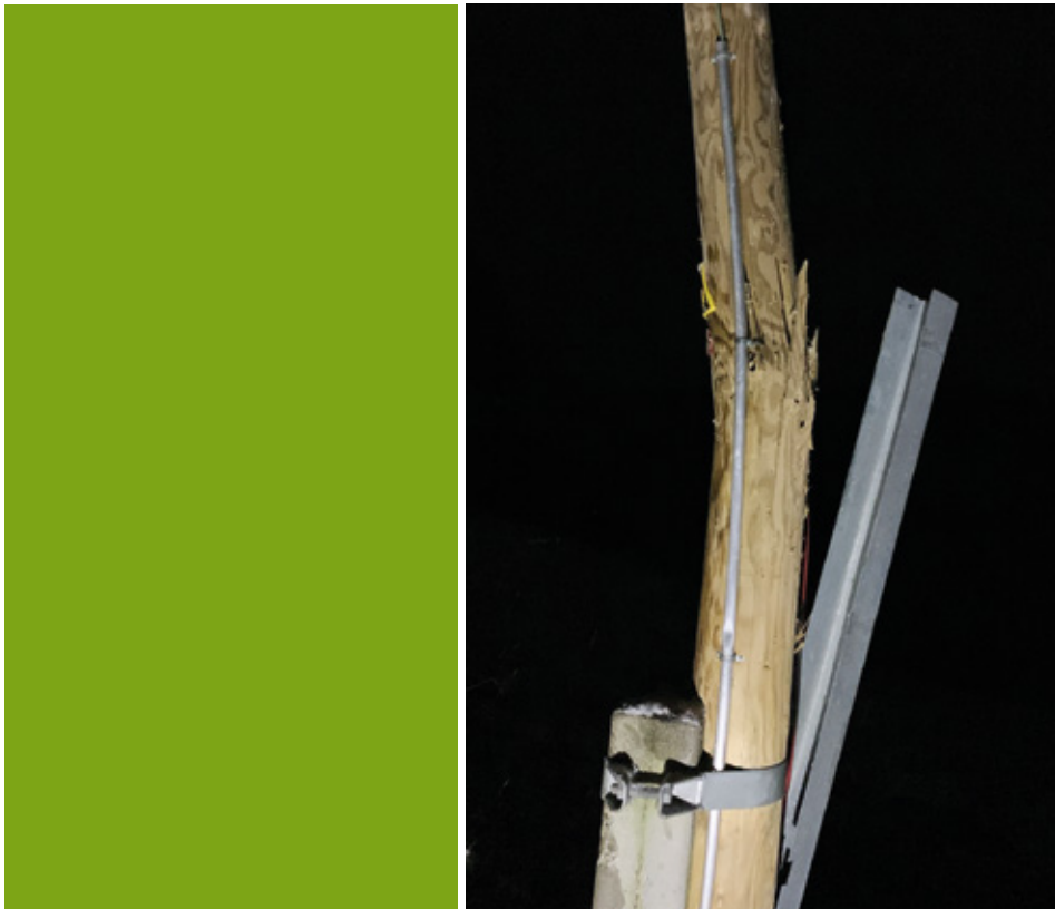
Beschädigter Mittelspannungs- Endmast auf der Geeralp
