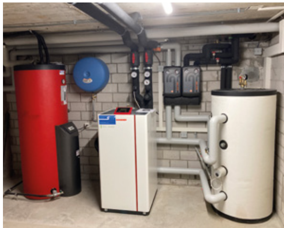
Fertig installierte Wärmepumpe mit Boiler und Pufferspeicher
